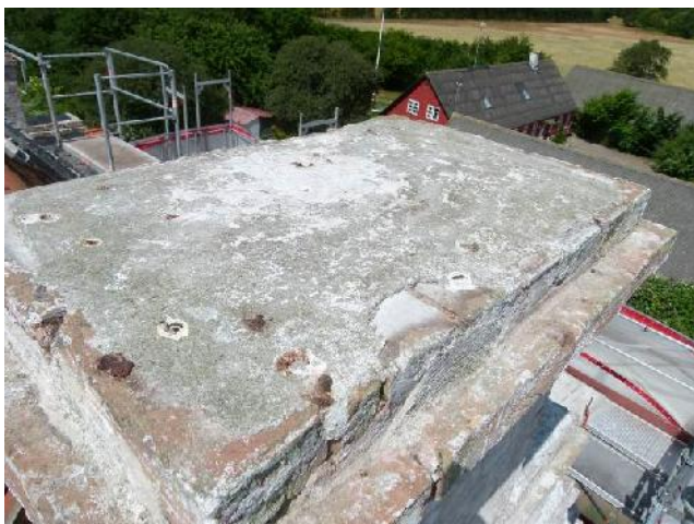
Øverste kamtak på østgavl. Her repareres med Lithomex, og på det udkragede skifte kan der evt. lægges skråkant med Lithomex.
