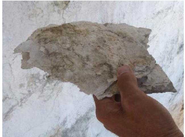
Cement har "spændt" kalklaget, der løsner i tykke flager.
