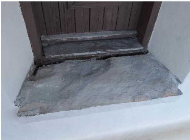
Den skadede sandsten på vestside. En reparation med Lihomex på bygges op med fald udefter. NB -Træværk skal forinden repareres.
