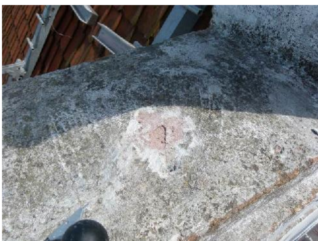
Her ses rest af den oprindelige afdækning med rødlig bornholmsk cement. Det løstsiddende hugges bort, og hullet repareres med Lithomex.
