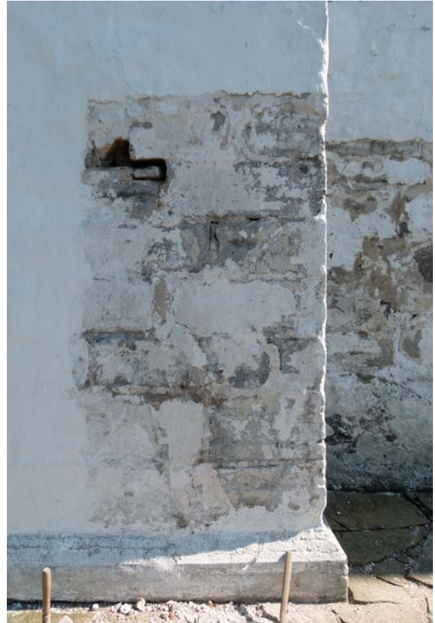
En afrenset flade, hvor løs puds er borthugget. Der viste sig en "hul" – måske et såkaldt "bomhul" fra det oprindelige stillads. Her var indmuret en mursten.
