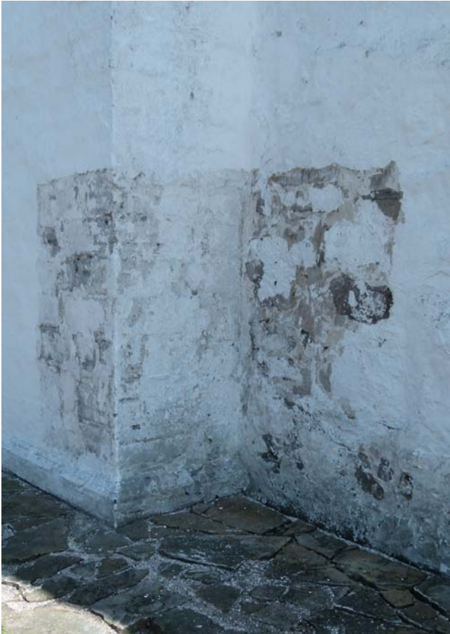
De afrensede felter inden udhugning af løs puds og fuger. Det er nemmere at afrense kalkstensmurværket end granitmurværket på tårnet.
