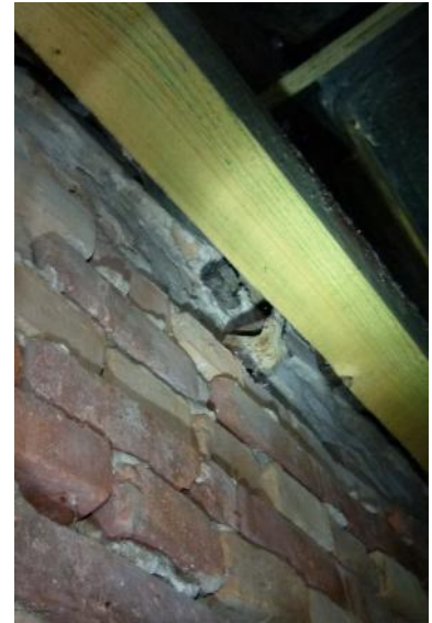
Ankrene har i dag ingen forbindelse til gavlspæret.
