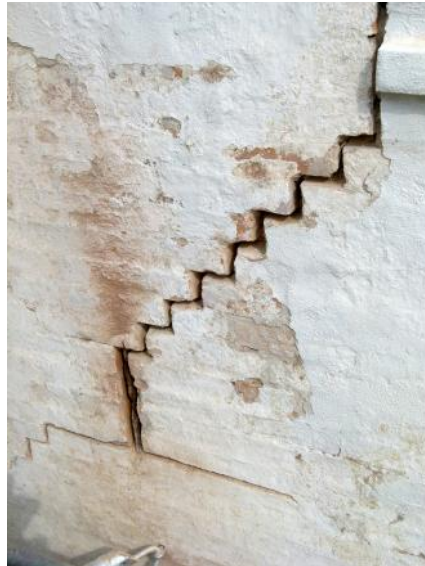
Resultat af rustsprængning. Fugeren er kradset ud.
