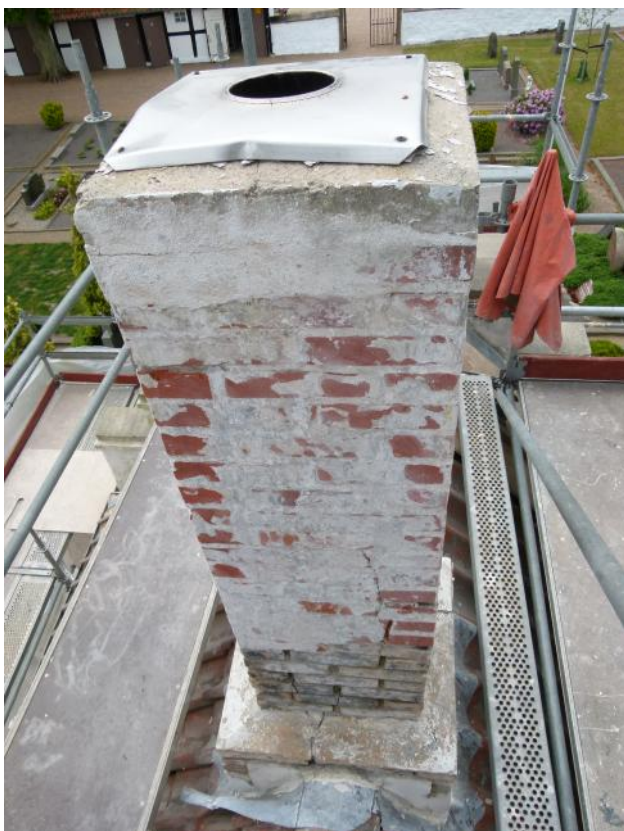
Skorstenen er forsynet med et stålrør. Betonafdækningen er revnet og løs.
